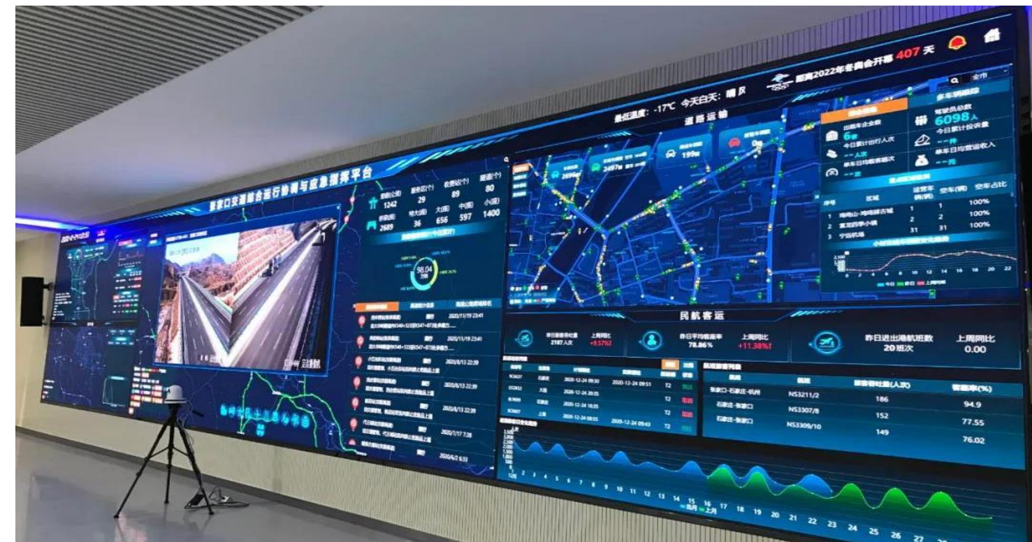
智能综合调度管理
